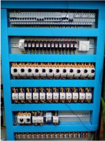
تابلو کنترل موتور MCC
