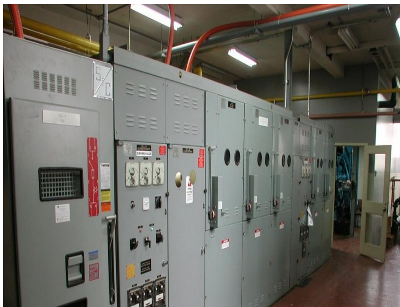
تجهیزات الکتریکی نصب ثابت
